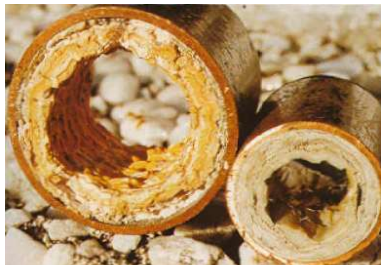
Obstrucción por agua dura y sobrecalentamiento
