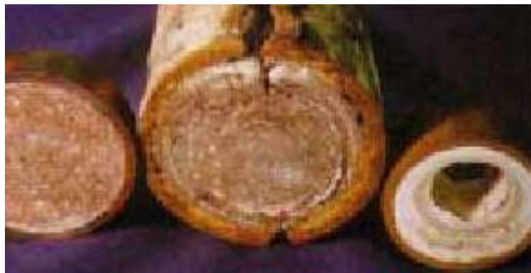
Obstrucción por agua dura y sobrecalentamiento
