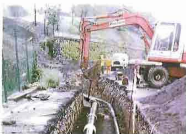
Fig. 5.18 Sector Gas Entre 1996-2005 el mayor esfuerzo de infraestructura de distribución gasista estará de la red doméstico-comercial
