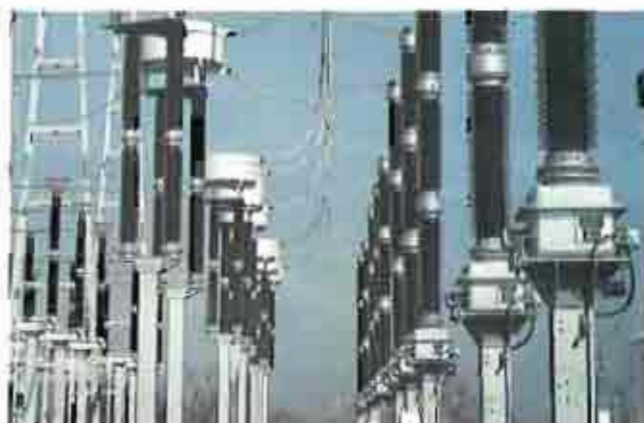
Fig. 2.22 Energía Eléctrica Mejoras en subestaciones de transformación para elevar los niveles de calidad del suministro eléctrico
