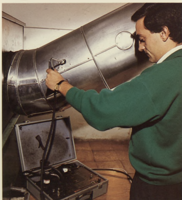
Análisis de gases de combustión en la caldera de una comunidad de vecinos.
