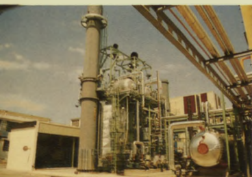
Instalaciones de cogeneración con turbina de gas.
