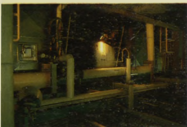
Caldera de vapor (Celulosa de Nervión, S.A.)
