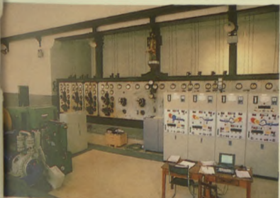
Interior de la central hidroeléctrica (Oñati).
