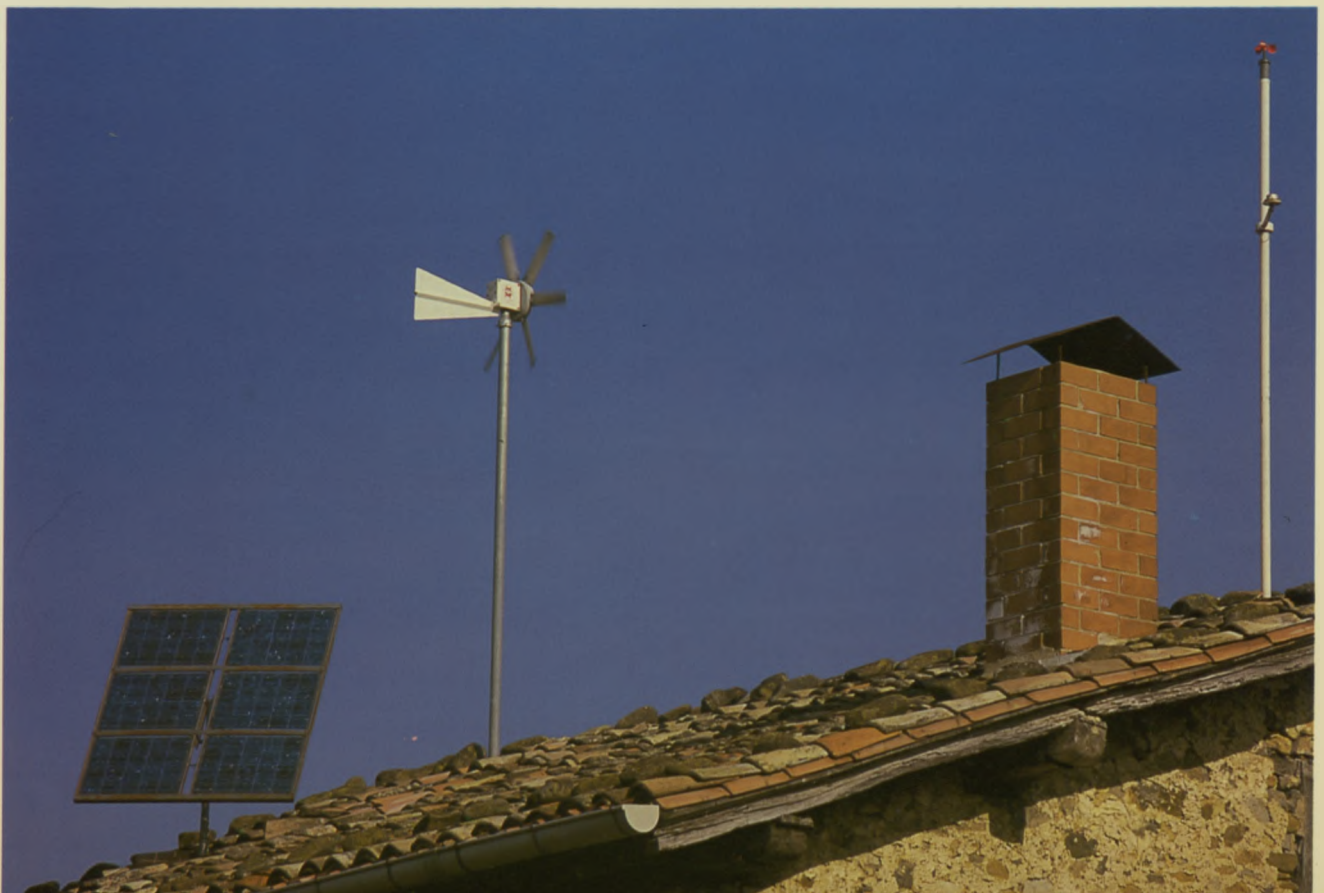
Instalación mixta eólico-solar para producción de electricidad.
