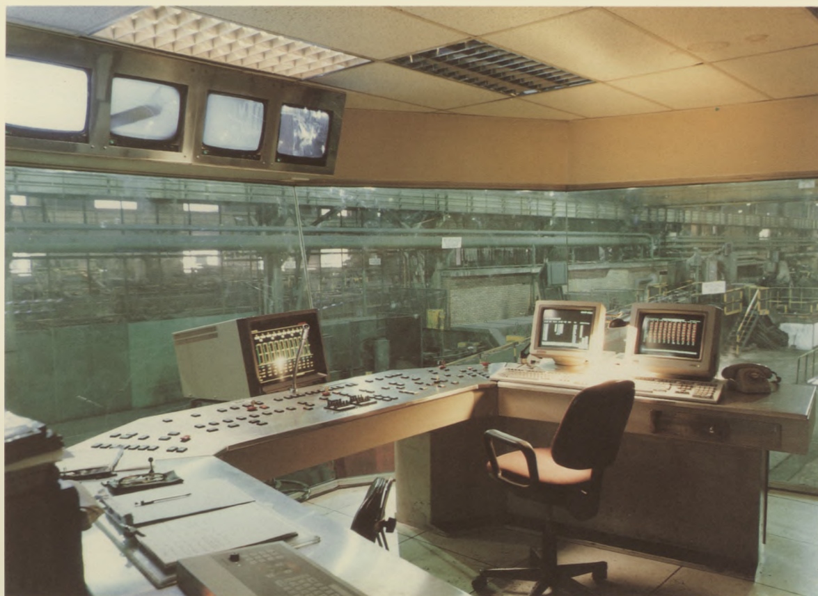
Cabina del subsistema de laminación de control del perfil térmico del tren Contiloop en ACENOR, S.A. (Vitoria)
