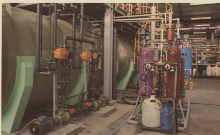
Planta prototipo de recuperación del sulfato de níquel en G.A.C. (Abadiano)
