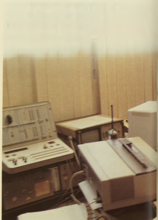
Puesto central de telecontrol para transporte y distribución de gas.
