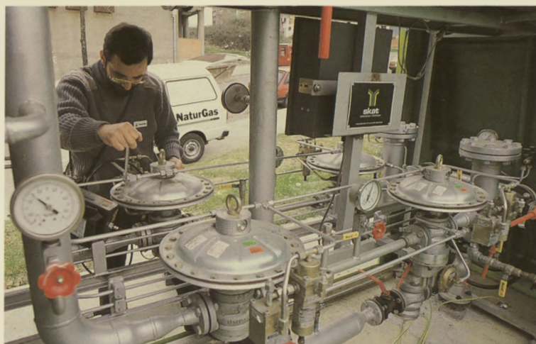
Operación de mantenimiento en estación de regulación y medida de NaturGas en Llodio
