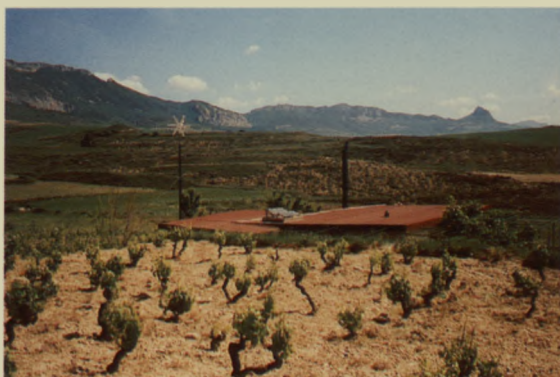
Suministro eléctrico a una vivienda aislada en La Rioja alavesa mediante sistema mixto eólico-fotovoltaico.
