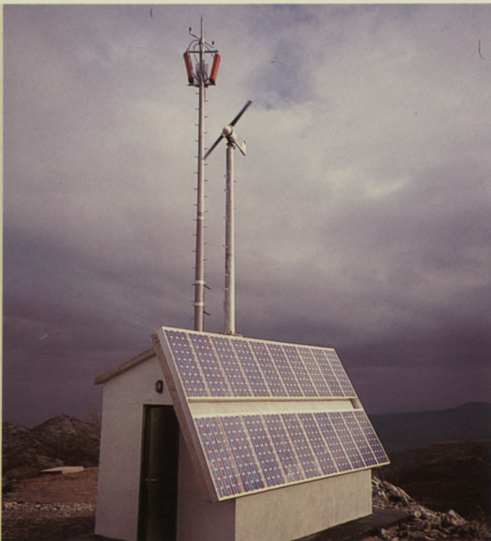
Electrificación mixta solar-eólica del repetidor de ETB del Valle de Lastur en Deba.
